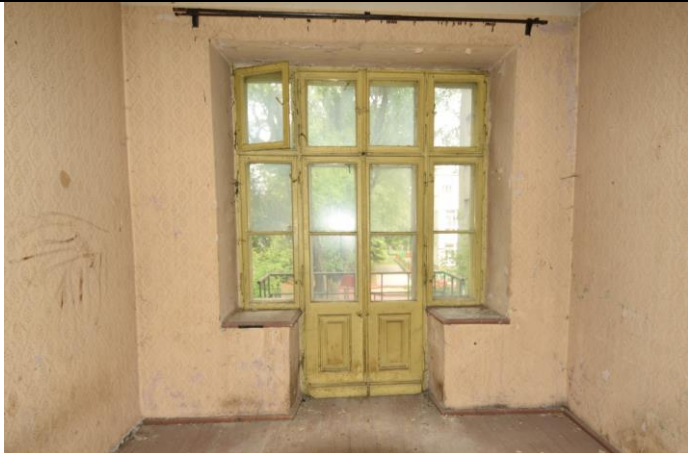
Wnętrze pokoju korpusu głównego od strony podwórza. Zachowana stolarka okienna.
